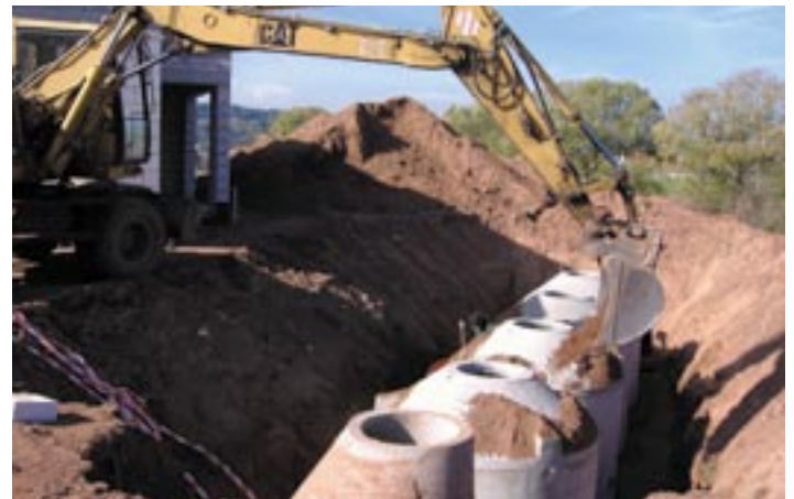
Nach dem Einbau der Wassertanks bleibt das Wasser kühl und von hoher Qualität.
