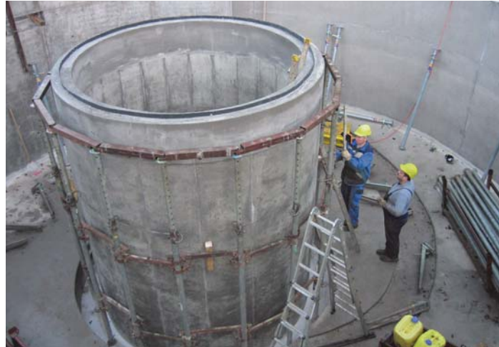
Die runde Form spart Platz und ermöglicht die weitestgehende Selbstreinigung des Beckens.
