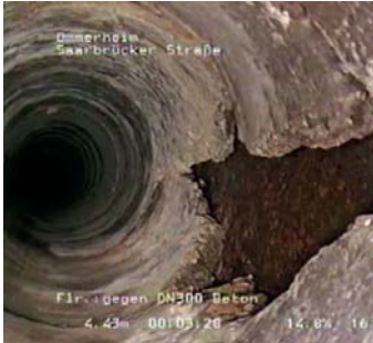
Ein typischer Schaden in einem Kanalrohr.
