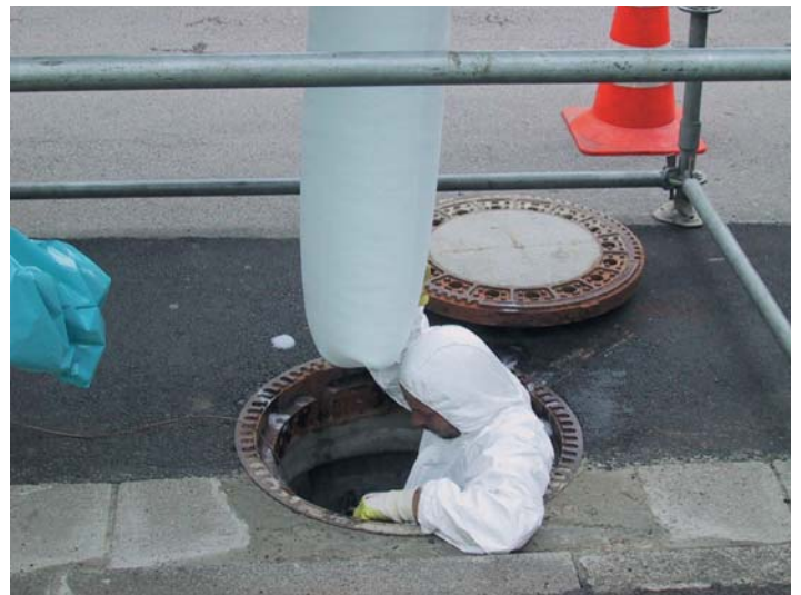
Noch ist der Inliner elastisch. Nach dem Ausspülen mit heißem Wasser wird er hart und dichtet den Kanal ab.
