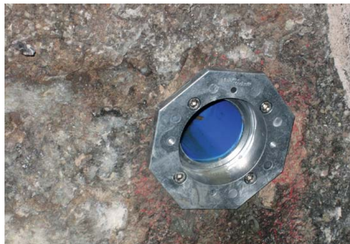
So sieht der installierte Hausanschluss aus.
